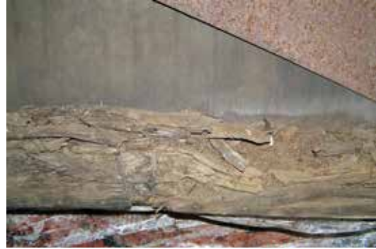
Syllen var rötskadad.
