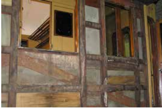
Stommen uppvisade många skador.
