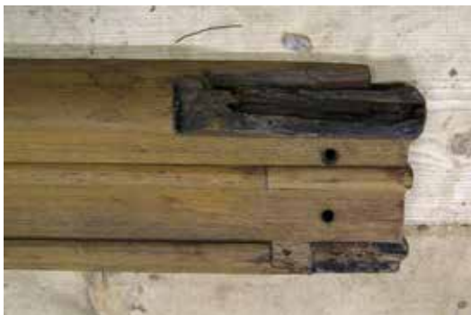
Många av krönlisterna var skadade i ändarna.
