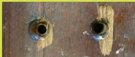
Bild 5. Skador vid demontering.
