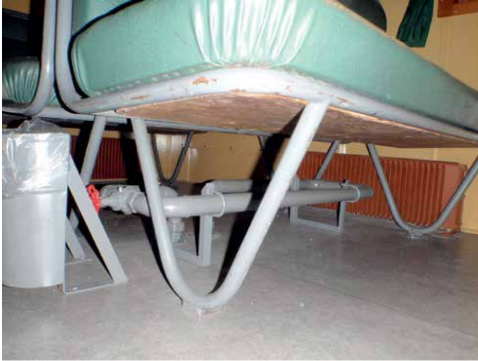
Ångrör under soffor.
