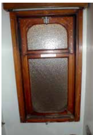
Fönster på toalett innan restaurering.
