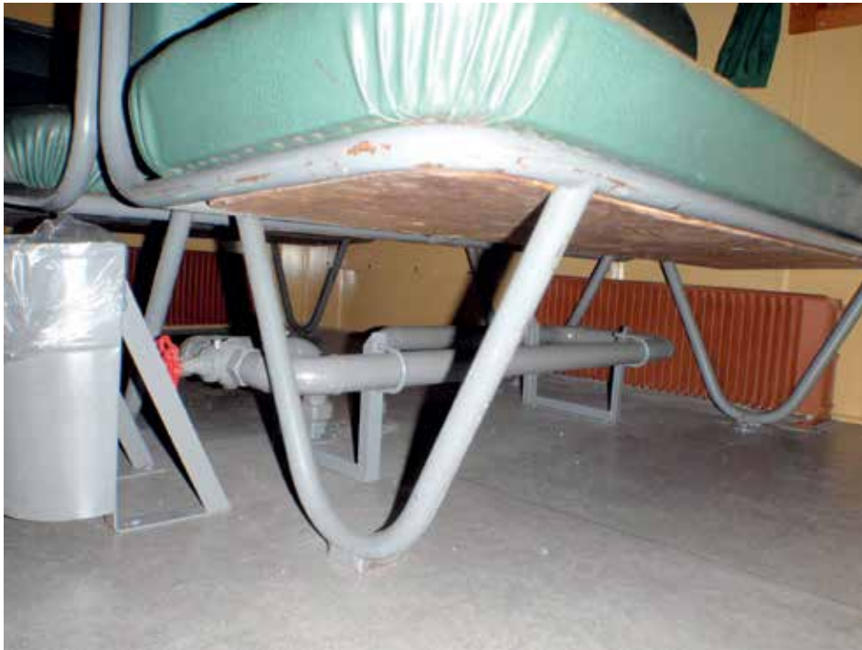
Ångrör under soffor.
