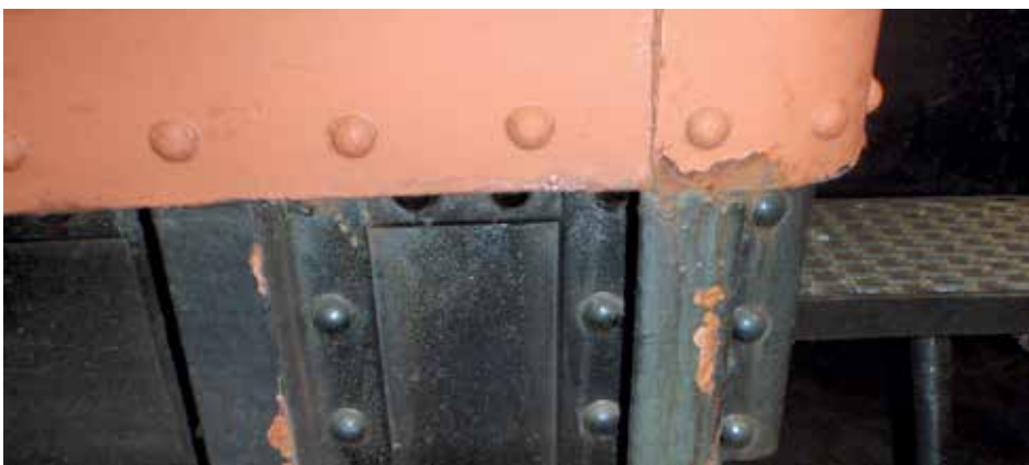
Rambalkarna var angripna av rost.
