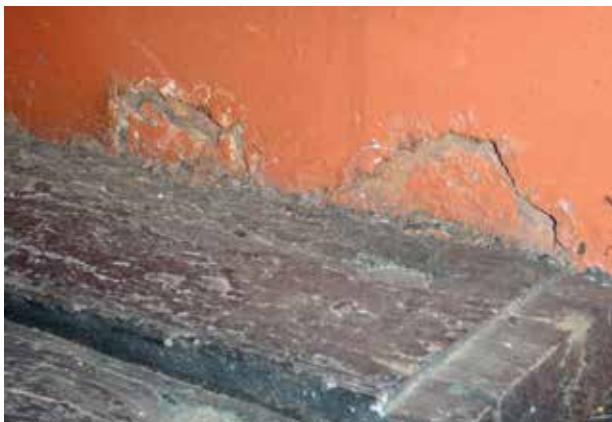
Rostskador på plåten vid golvet på en av plattformarna.
