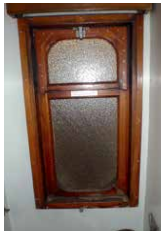
Fönster på toalett innan restaurering.
